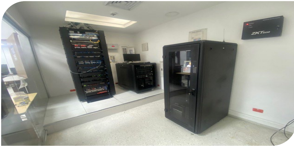
Fuente. Propia - Ilustración 13 DataCenter1
